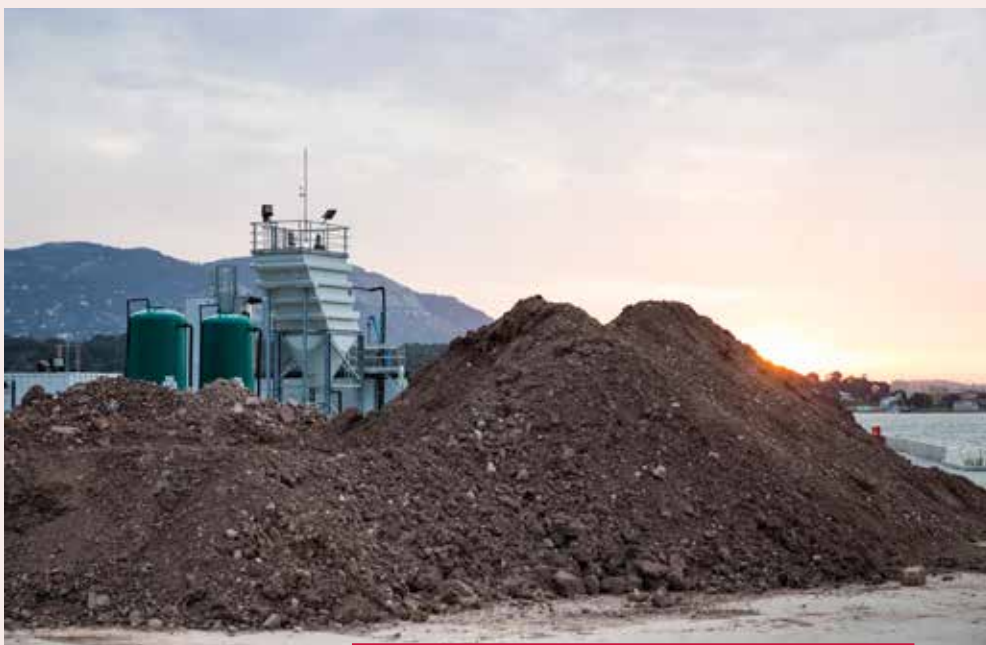
De vervuilde sedimenten worden gesplitst in zand en fijne klei. De zandfractie wordt gereinigd en opnieuw gebruikt.
